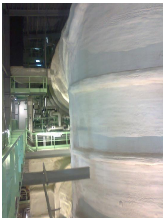
Obrázok 6 pohľad na hlavné vzdušné potrubie a jeho 15 cm oplášťovanie izolačným materiálom
