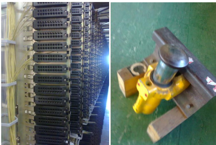
Obrázok 4 Jeden z mnohých blokov ovládacích prvkov reléového zabezpečovacieho zariadenia CZS (v útrobách hlavnej budovy) a vpravo ukážka jedného z mnohých retardérov
